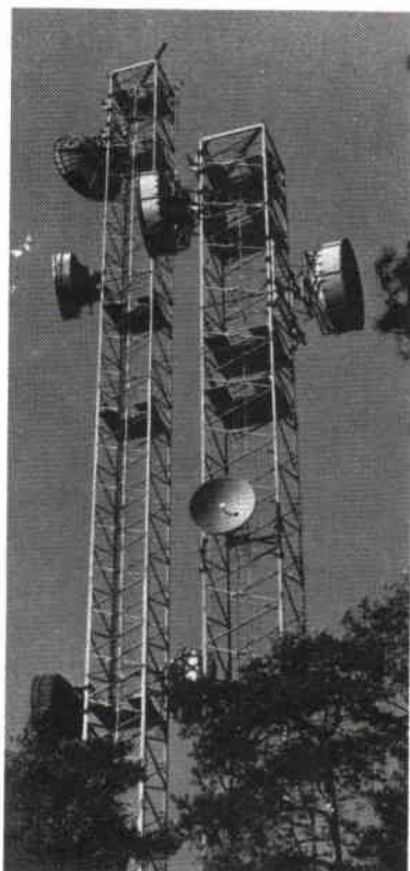
Radialänktorn med omfattande antensystem
